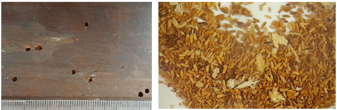
Fig. 4. Orificii de eclozare ale insectelor xilofage (a) și aspectul excrementelor scuturate din galerii (b)
