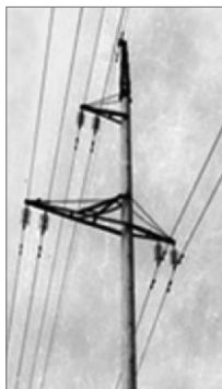
Vedere LEDA 35 kV
